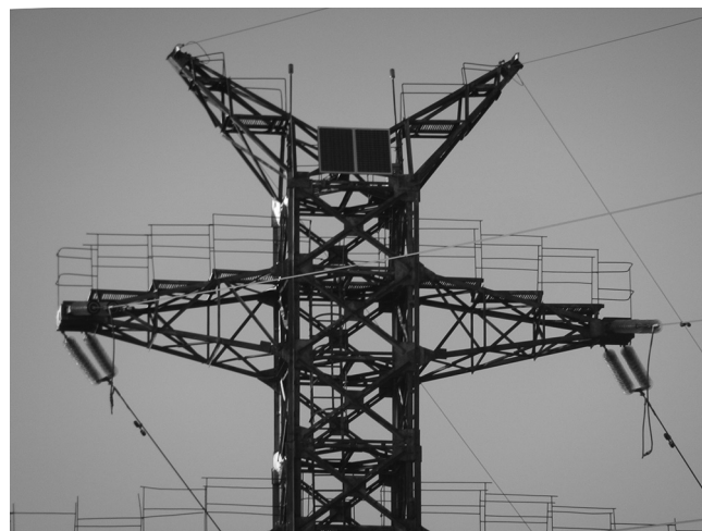
Рис. 4. Фотография реализации проекта автономной системы заградительного освещения опоры ЛЭП
